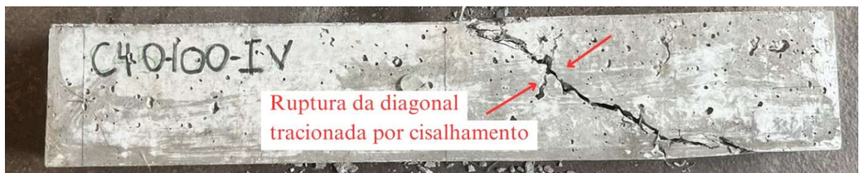
Figura 72 - Panorama de fissuração do grupo C40-100
